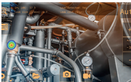
Wyciek sprężonego powietrza
